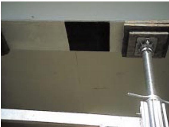
Refuerzo con fibra de carbono en vigas de edificio estacionamiento en Long Beach, CA.
