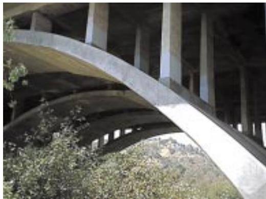
Refuerzo con fibra de vidrio en columnas, puente carretero en Los Angeles, CA.
